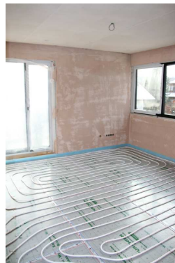
Fußbodenheizung im Kinderzimmer
