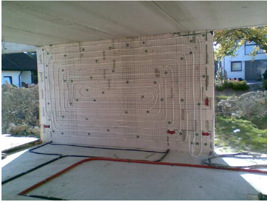
Die Rohrleitungen für die Wandheizung im Wohnzimmer
