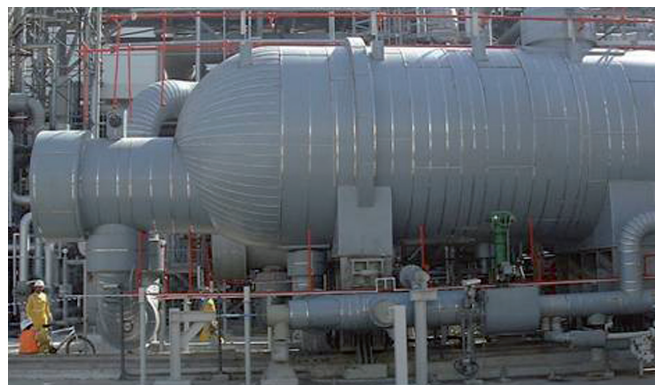
Propane Chiller in LNG plant
